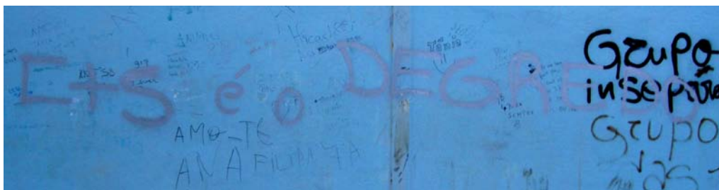
Fig. 24 – “C+S é o degrado” (graffiti na parede de uma escola EB23)
